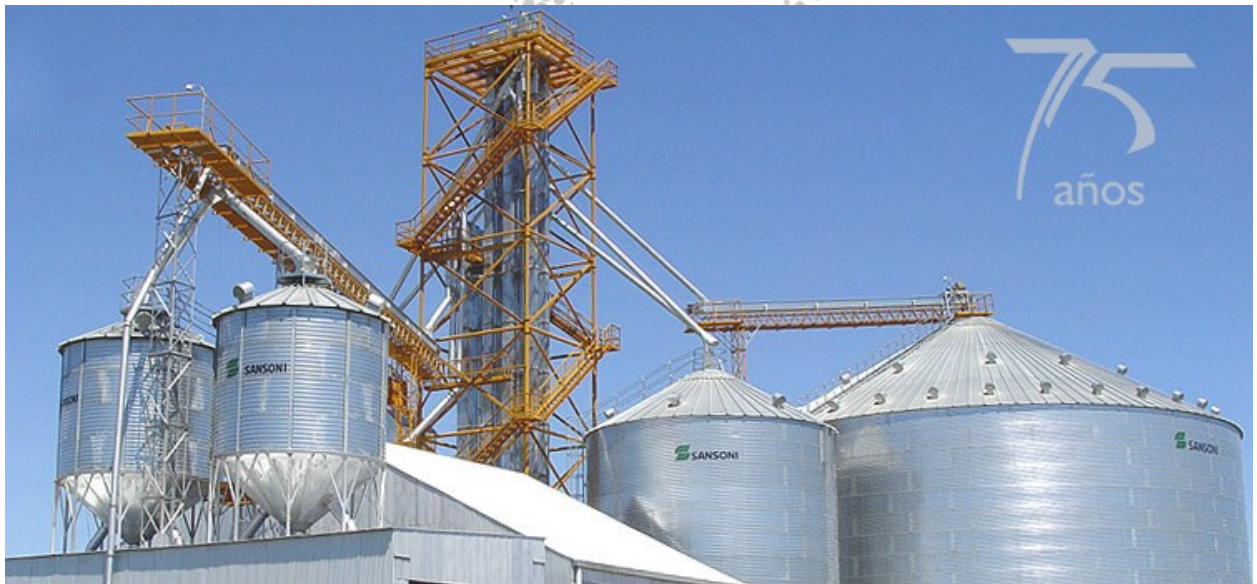
Elevador de Cangilones en Torre de Norias
