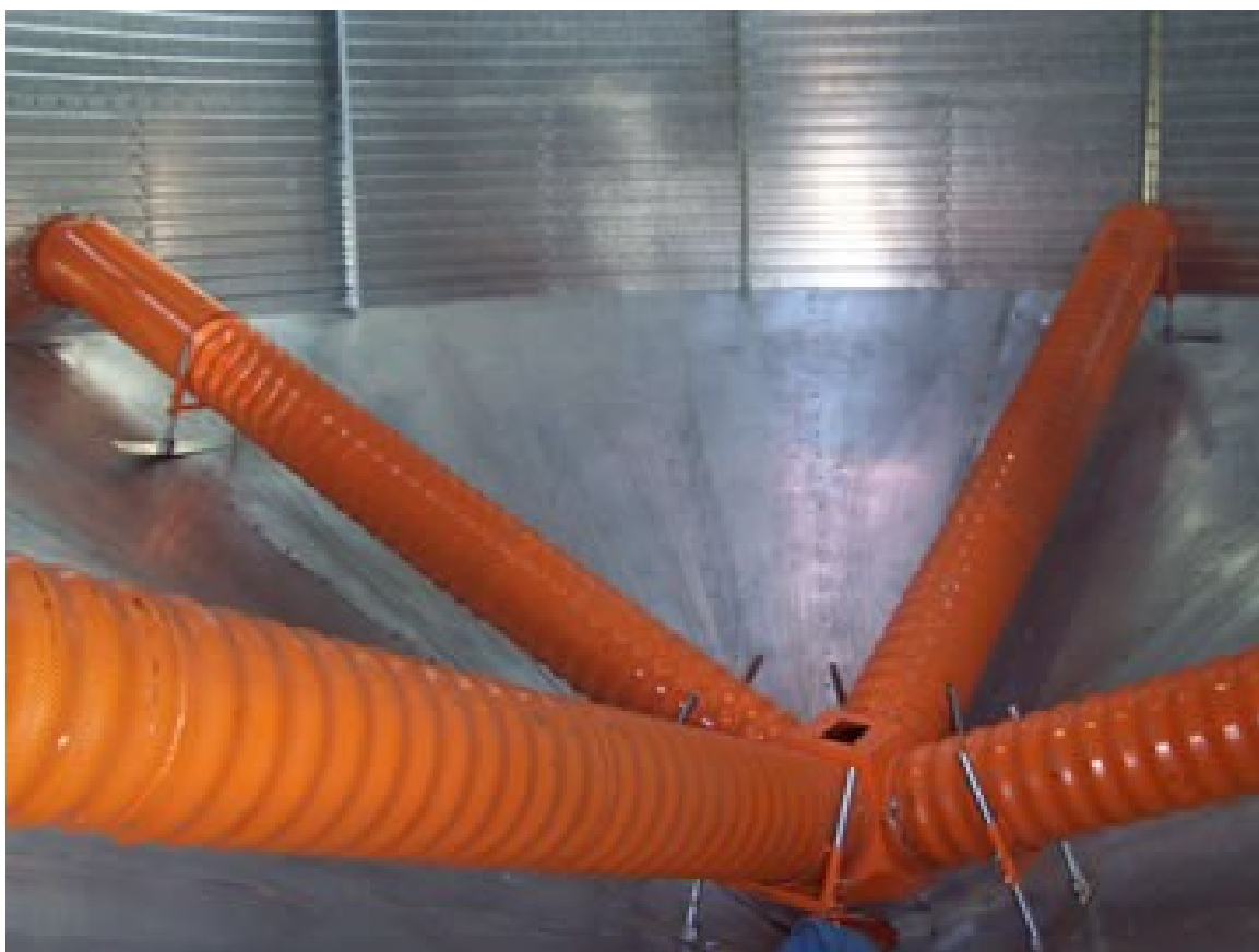
Sistema de distribución de aire
